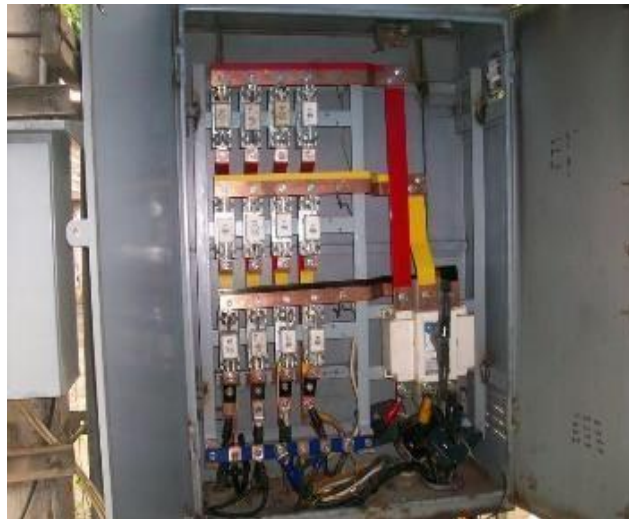
Gambar 2. 10 Perangkat Hubung Bagi Tegangan Rendah (PHBTR)
