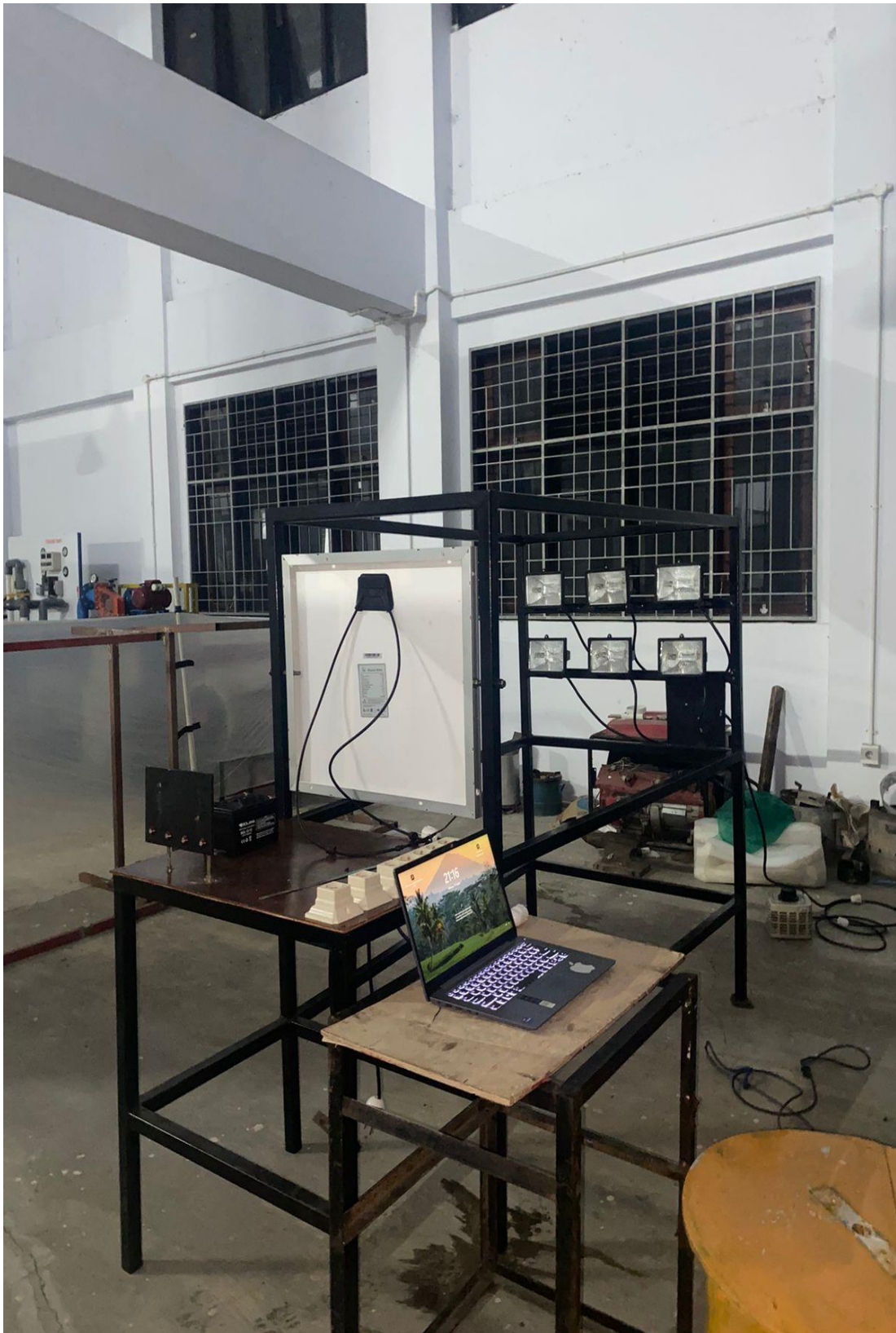
Gambar L-.9 Instalasi solar cell tampak depan
