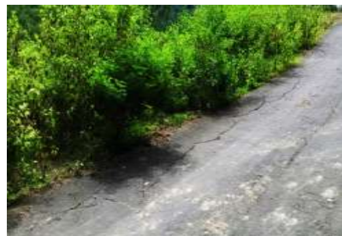
Panjang kerusakan: 11,80 m Tingkat kerusakan: High
