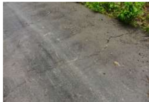
Panjang kerusakan: 2,50 m Tingkat kerusakan: Low
