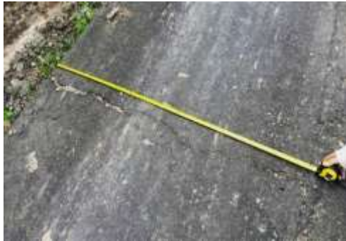
Panjang kerusakan: 1,50 m Tingkat kerusakan: Low
