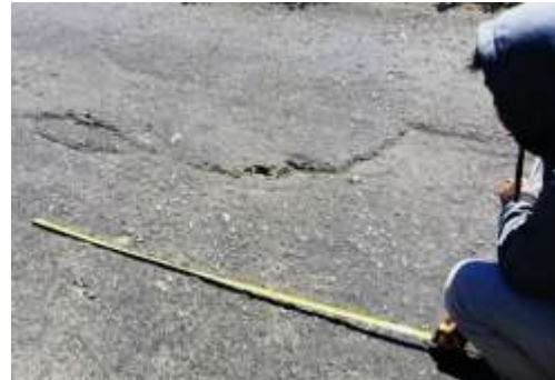
Panjang kerusakan: 1,31 m Tingkat kerusakan: Low
