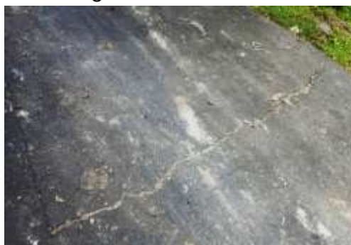
Panjang kerusakan: 2,60 m Tingkat kerusakan: Low
