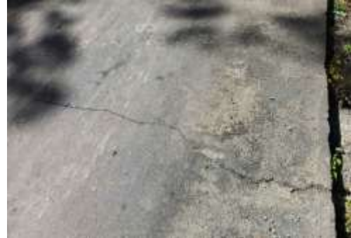
Panjang kerusakan: 2,04 m Tingkat kerusakan: Low
