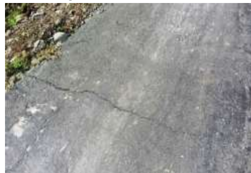
Panjang kerusakan: 2,08 m Tingkat kerusakan: Low
