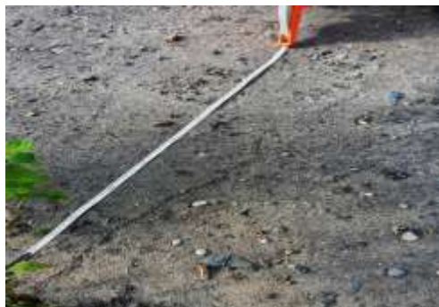
Panjang kerusakan: 0,92 m
