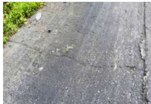
Panjang kerusakan: 1,89 m Tingkat kerusakan: Low
