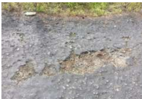
Luas kerusakan: 0,88 m 2 Tingkat kerusakan: Low
