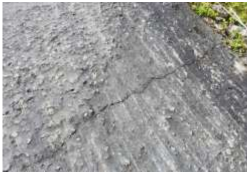
Panjang kerusakan: 2,05 m Tingkat kerusakan: Low
