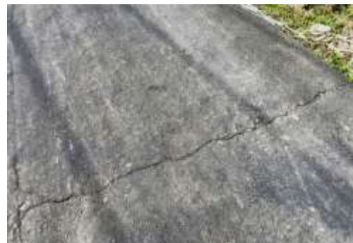
Panjang kerusakan: 2,15 m Tingkat kerusakan: Low
