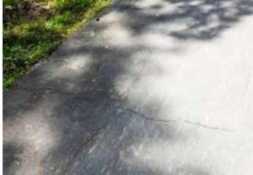
Panjang kerusakan: 2,08 m Tingkat kerusakan: (Low)
