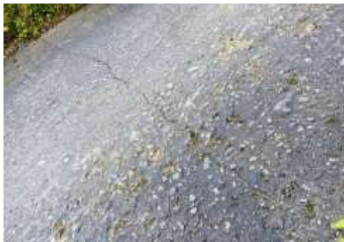
Panjang kerusakan: 4 m Tingkat kerusakan: Low
