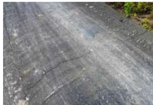
Panjang kerusakan: 2,26 m Tingkat kerusakan: Low
