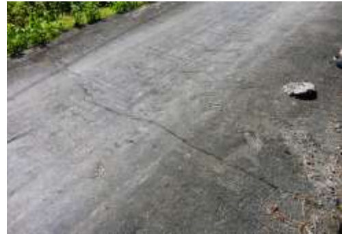
Panjang kerusakan: 4 m Tingkat kerusakan: Low
