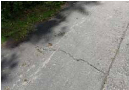
Panjang kerusakan: 2,03 m Tingkat kerusakan: Low
