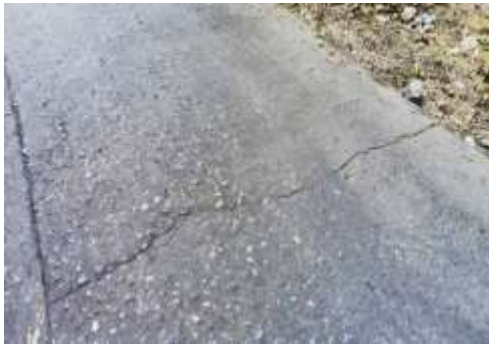
Panjang kerusakan: 2,11 m Tingkat kerusakan: Low
