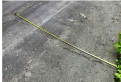
Panjang kerusakan: 2,50 m Tingkat kerusakan: Low
