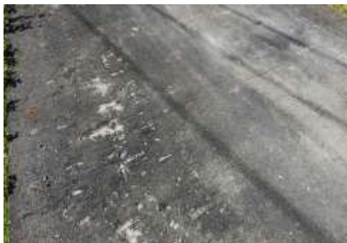
Panjang kerusakan: 4 m Tingkat kerusakan: Low
