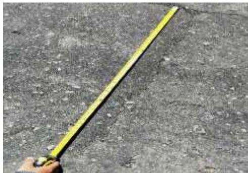
Panjang kerusakan: 0,82 m
