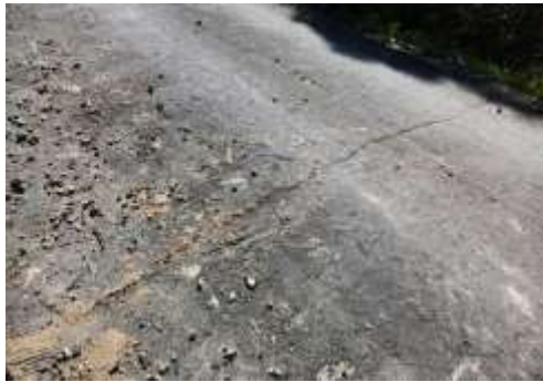
Panjang kerusakan: 4 m Tingkat kerusakan: Low
