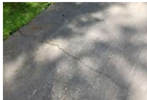
Panjang kerusakan: 2,08 m Tingkat kerusakan: Low
