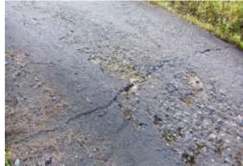
Panjang kerusakan: 4 m Tingkat kerusakan: Low
