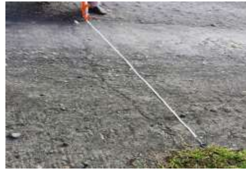
Panjang kerusakan: 2,20 Tingkat kerusakan: Low
