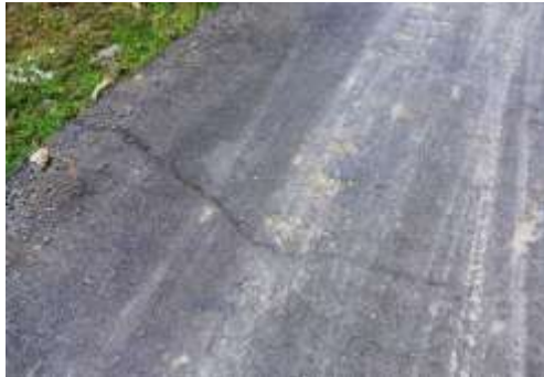
Panjang kerusakan: 2,20 m Tingkat kerusakan: Low
