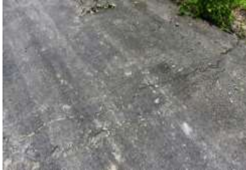
Panjang kerusakan: 2,50 m Tingkat kerusakan: Low
