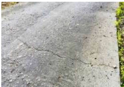
Panjang kerusakan: 2,30 m Tingkat kerusakan: Low
