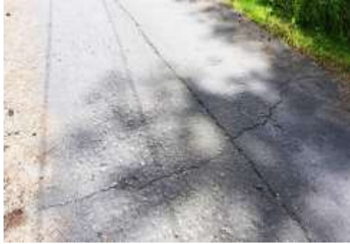
Panjang kerusakan: 4 m Tingkat kerusakan: Low
