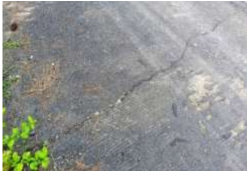
Panjang kerusakan: 2,08 m Tingkat kerusakan: Low
