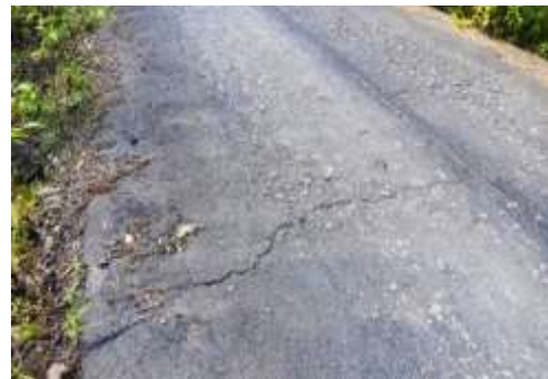
Panjang kerusakan: 2,10 m Tingkat kerusakan: Low
