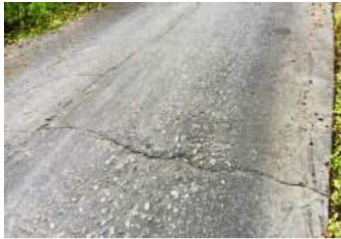
Panjang kerusakan: 2,05 m Tingkat kerusakan: Low
