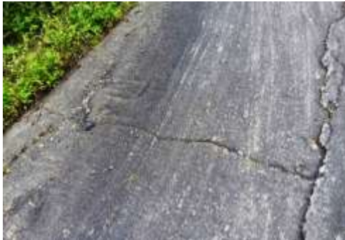
Panjang kerusakan: 2,06 m Tingkat kerusakan: Low
