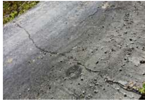
Panjang kerusakan: 4 m Tingkat kerusakan: Low
