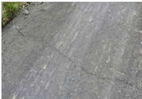
Panjang kerusakan: 1,50 m Tingkat kerusakan: Low
