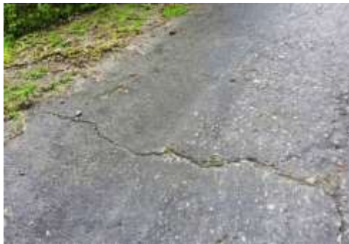
Panjang kerusakan: 1,93 m Tingkat kerusakan: Low
