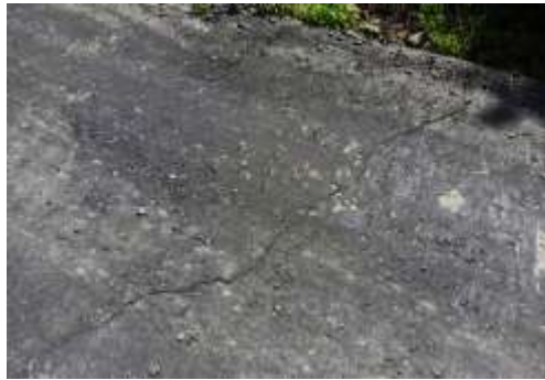
Panjang kerusakan: 3 m Tingkat kerusakan: Low
