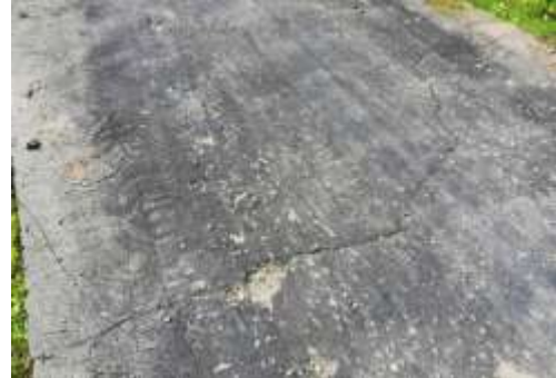
Panjang kerusakan: 4,15 m Tingkat kerusakan: Low
