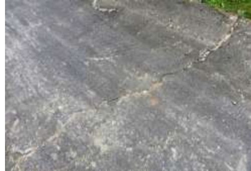
Panjang kerusakan: 2,60 m Tingkat kerusakan: Low
