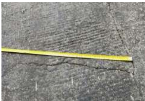
Panjang kerusakan: 0,61 m
