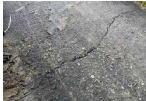
Panjang kerusakan: 3,45 m Tingkat kerusakan: Low
