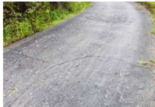
Panjang kerusakan: 4,08 m Tingkat kerusakan: Low
