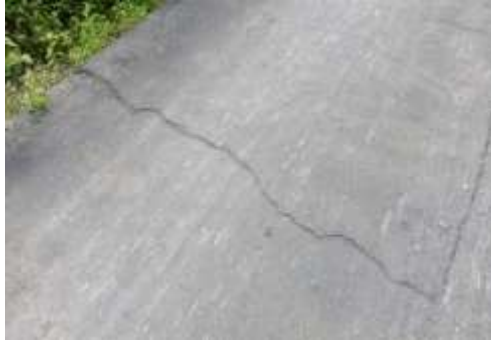
Panjang kerusakan: 2,10 m Tingkat kerusakan: Low
