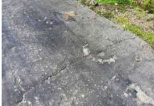
Panjang kerusakan: 2,07 m Tingkat kerusakan: Low
