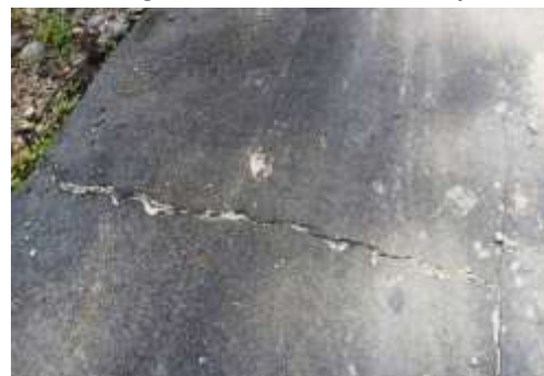
Panjang kerusakan: 2,50 m Tingkat kerusakan: Low
