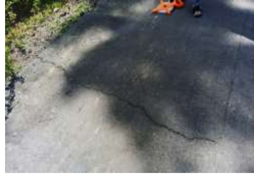
Panjang kerusakan: 2,03 m Tingkat kerusakan: Low
