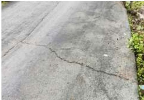
Panjang kerusakan: 2,07 m Tingkat kerusakan: Low
