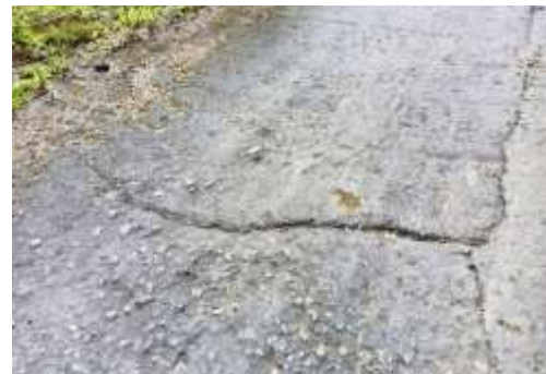
Panjang kerusakan: 1,59 m Tingkat kerusakan: Low
