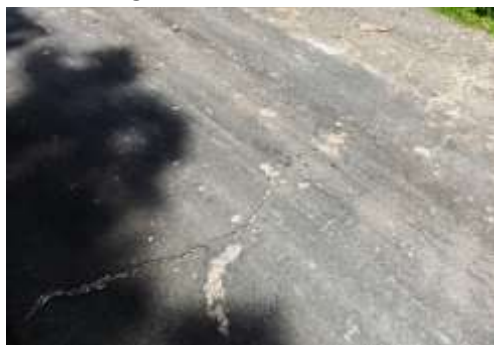
Panjang kerusakan: 4 m Tingkat kerusakan: Low
