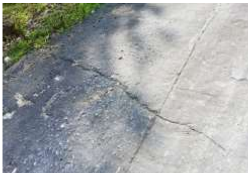
Panjang kerusakan: 2,92 m Tingkat kerusakan: Low
