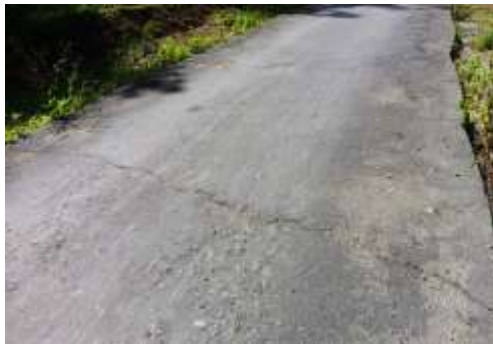
Panjang kerusakan: 4 m Tingkat kerusakan: Low
