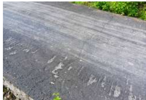
Panjang kerusakan: 4 m Tingkat kerusakan: Low
