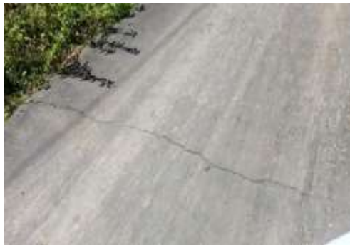
Panjang kerusakan: 2,09 m Tingkat kerusakan: Low
