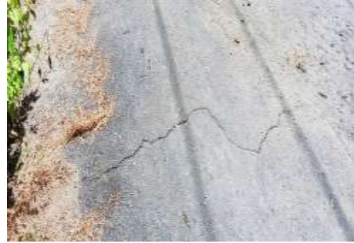
Panjang kerusakan: 2 m Tingkat kerusakan: Low
