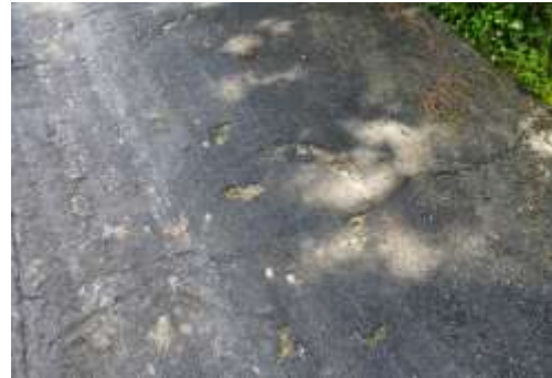
Panjang kerusakan: 2,05 m Tingkat kerusakan: Low
