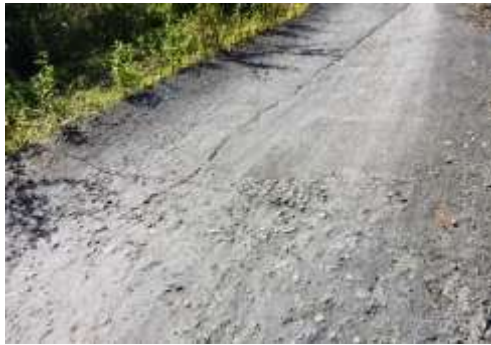
Panjang kerusakan: 4 m Tingkat kerusakan: Low
