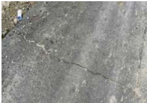
Panjang kerusakan: 2,10 m Tingkat kerusakan: Low
