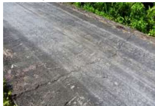
Panjang kerusakan: 4 m Tingkat kerusakan: Low
