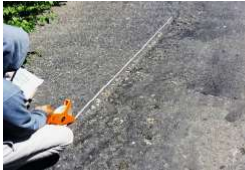
Panjang kerusakan: 3,20 m Tingkat kerusakan: Low
