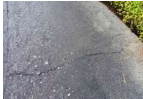
Panjang kerusakan: 2,02 m Tingkat kerusakan: Low
