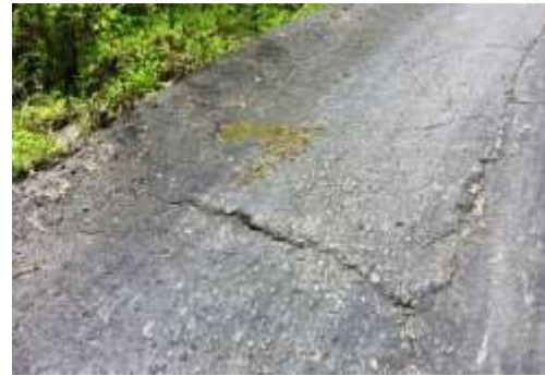
Panjang kerusakan: 1,31 m Tingkat kerusakan: Low
