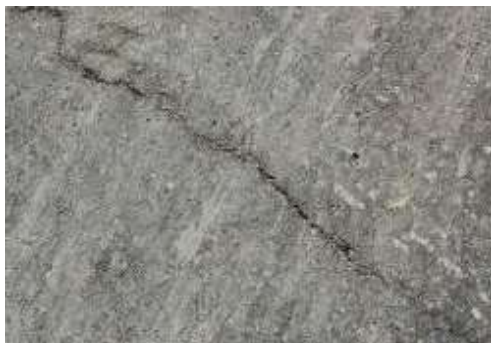
Panjang kerusakan: 0,98 m
