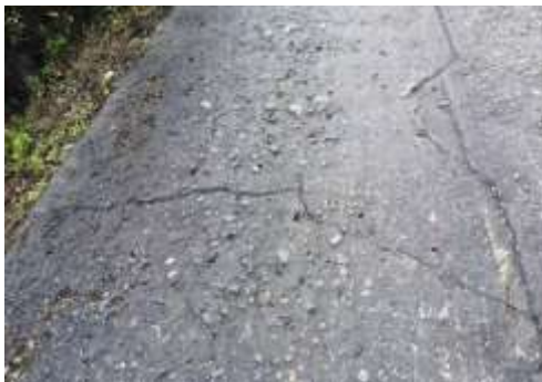
Panjang kerusakan: 2,07 m Tingkat kerusakan: Low
