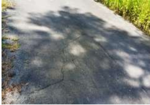
Panjang kerusakan: 4,20 m Tingkat kerusakan: Low )
