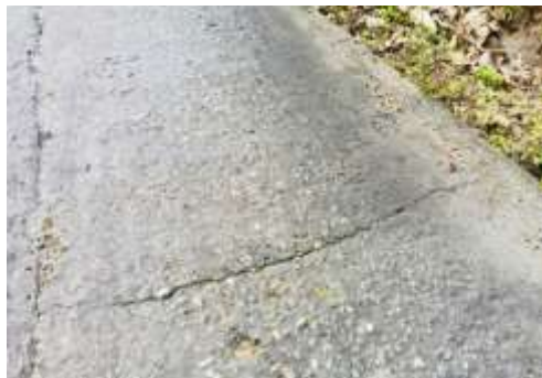
Panjang kerusakan: 2,19 m Tingkat kerusakan: Low
