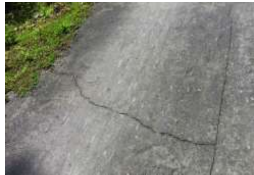
Panjang kerusakan: 2.02 m Tingkat kerusakan: Low
