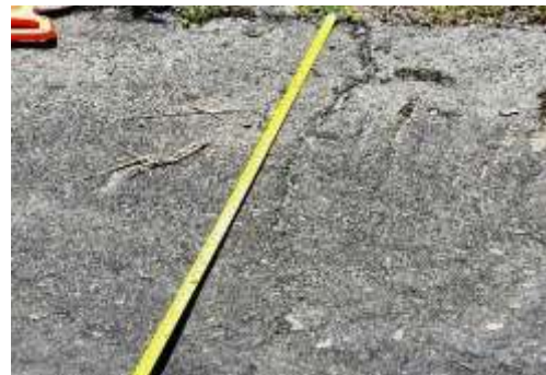
Panjang kerusakan: 0,95 m
