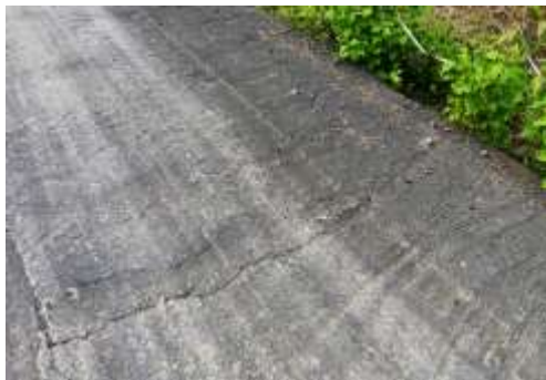
Panjang kerusakan: 2,10 m Tingkat kerusakan: Low
