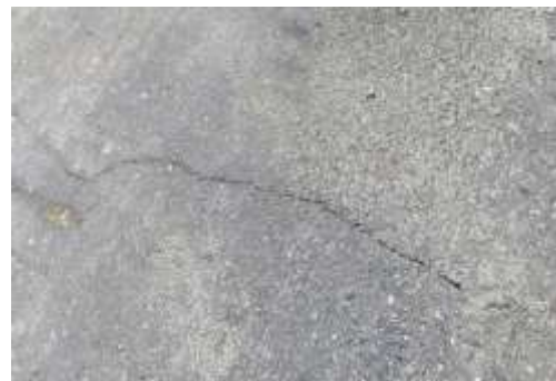
Panjang kerusakan: 0,66 m
