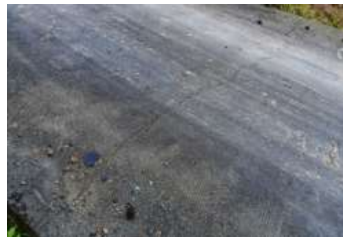
Panjang kerusakan: 4 m Tingkat kerusakan: Low
