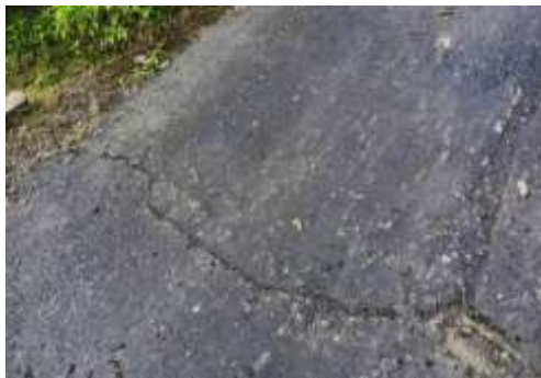
Panjang kerusakan: 2 m Tingkat kerusakan: Low
