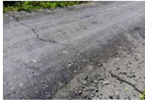
Panjang kerusakan: 4 m Tingkat kerusakan: Low
