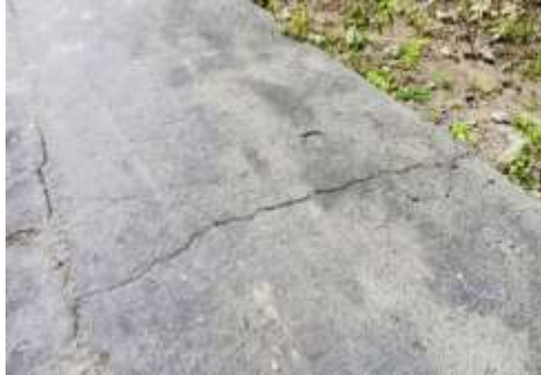
Panjang kerusakan: 2,10 m Tingkat kerusakan: Low
