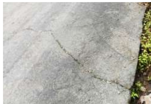
Panjang kerusakan: 0,99 m
