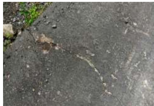
Panjang kerusakan: 0,90 m
