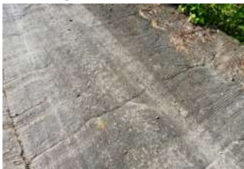
Panjang kerusakan: 2,17 m Tingkat kerusakan: Low
