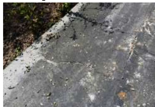
Panjang kerusakan: 1,60 m Tingkat kerusakan: Low
