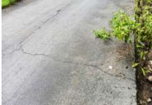
Panjang kerusakan: 2,05 m Tingkat kerusakan: Low
