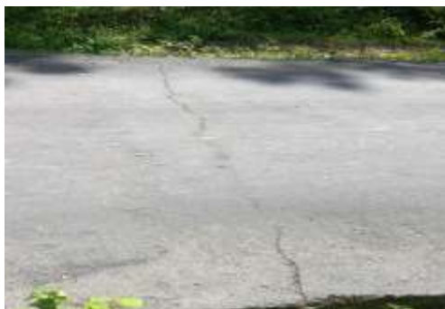
Panjang kerusakan: 4 m Tingkat kerusakan: Low
