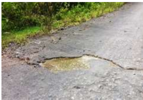
Panjang kerusakan: 2,08 m Tingkat kerusakan: Low
