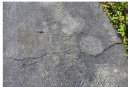
Panjang kerusakan: 1,32 m Tingkat kerusakan: ( Low )
