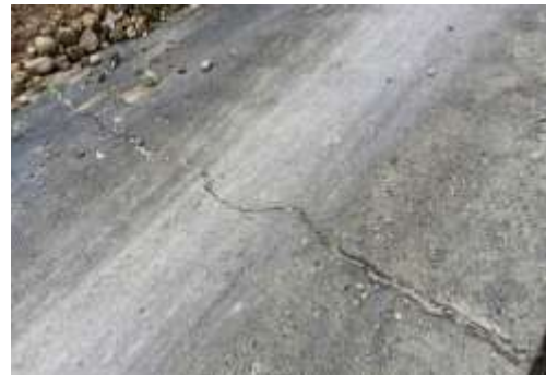
Panjang kerusakan: 4 m Tingkat kerusakan: Low
