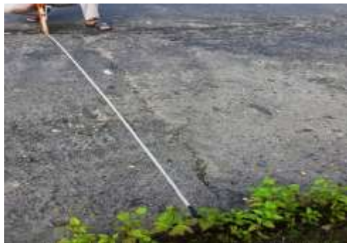
Panjang kerusakan: 2,50 m Tingkat kerusakan: Low
