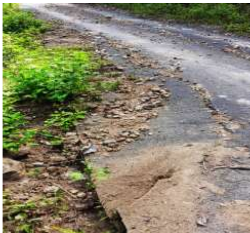
Panjang kerusakan: 8,79 m Tingkat kerusakan: High
