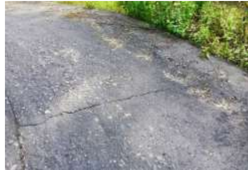
Panjang kerusakan: 2,43 m Tingkat kerusakan: Low
