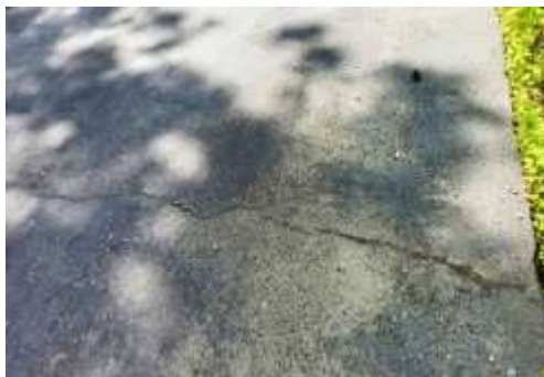
Panjang kerusakan: 2,13 m Tingkat kerusakan: Low
