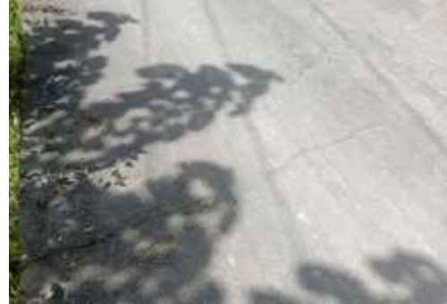
Panjang kerusakan: 2,06 m Tingkat kerusakan: Low
