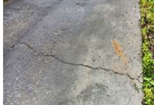
Panjang kerusakan: 2,18 m Tingkat kerusakan: Low
