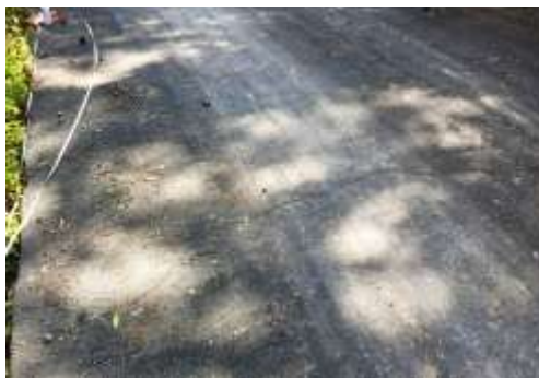
Panjang kerusakan: 2,19 m Tingkat kerusakan: Low
