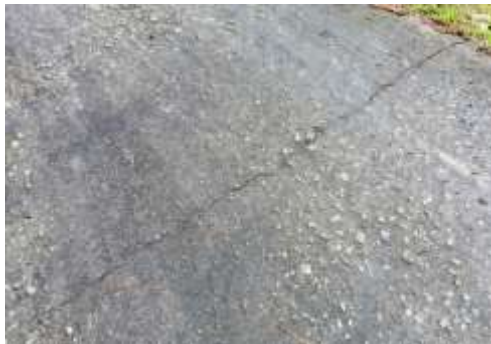
Panjang kerusakan: 2 m Tingkat kerusakan: Low
