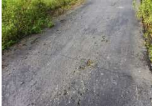
Panjang kerusakan: 4 m Tingkat kerusakan: Low
