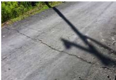
Panjang kerusakan: 4 m Tingkat kerusakan: Low
