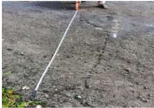
Panjang kerusakan: 2,60 m Tingkat kerusakan: Low
