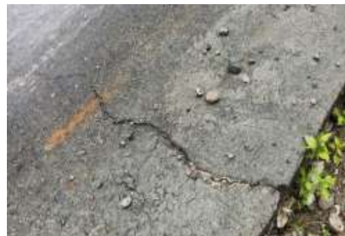
Panjang kerusakan: 0,80 m Tingkat kerusakan: Low
