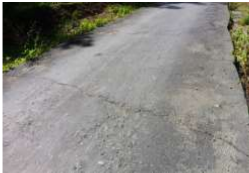
Panjang kerusakan: 4 m Tingkat kerusakan: Low
