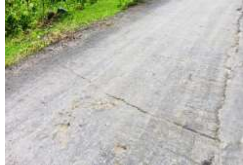
Panjang kerusakan: 1,31 m Tingkat kerusakan: Low
