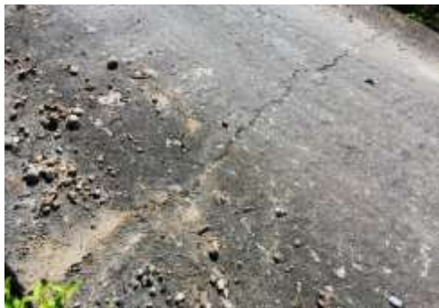
Panjang kerusakan: 4 m Tingkat kerusakan: Low
