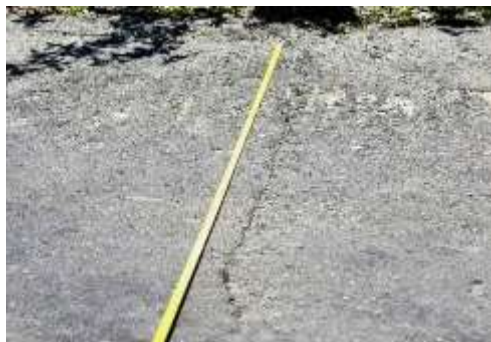
Panjang kerusakan: 1,60 m Tingkat kerusakan: Low
