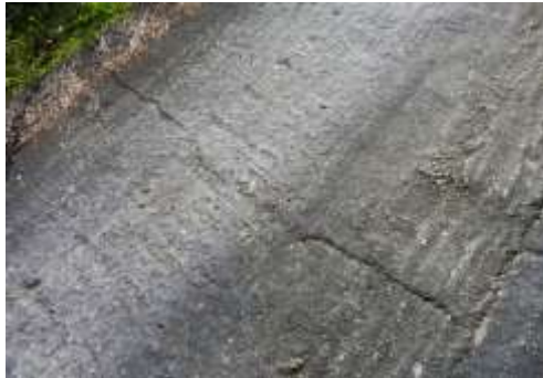
Panjang kerusakan: 2,09 m Tingkat kerusakan: Low
