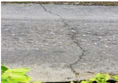
Panjang kerusakan: 4 m Tingkat kerusakan: Low
