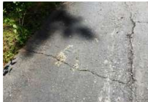
Panjang kerusakan: 2,05 m Tingkat kerusakan: Low
