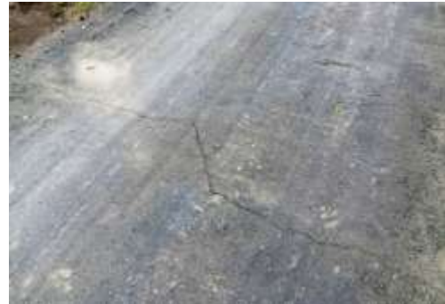
Panjang kerusakan: 4 m Tingkat kerusakan: Low
