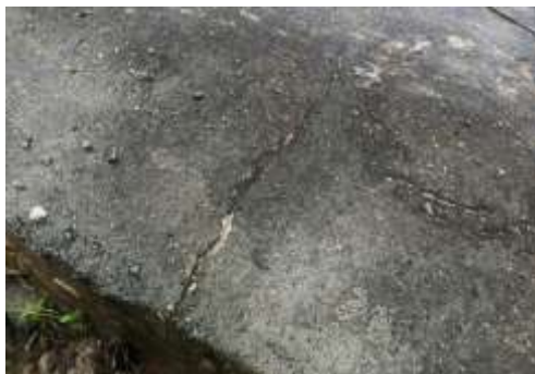
Panjang kerusakan: 0,70 m
