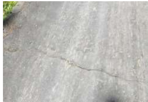
Panjang kerusakan: 1,44 m Tingkat kerusakan: Low
