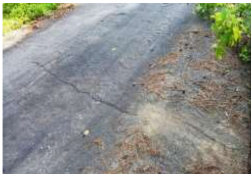
Panjang kerusakan: 4 m Tingkat kerusakan: Low
