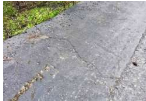
Panjang kerusakan: 2,03 m Tingkat kerusakan: ( Low )
