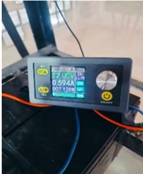
Gambar 3. Pengukuran Menggunakan Watt Meter
