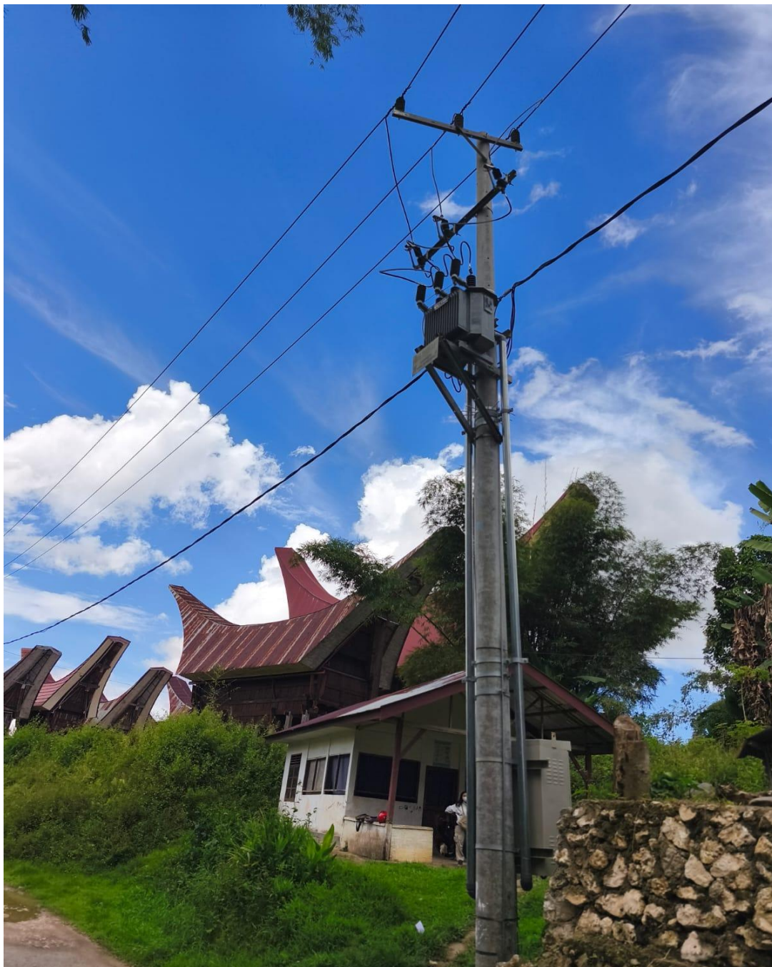
Gardu Trafo Tondon Siba'ta
