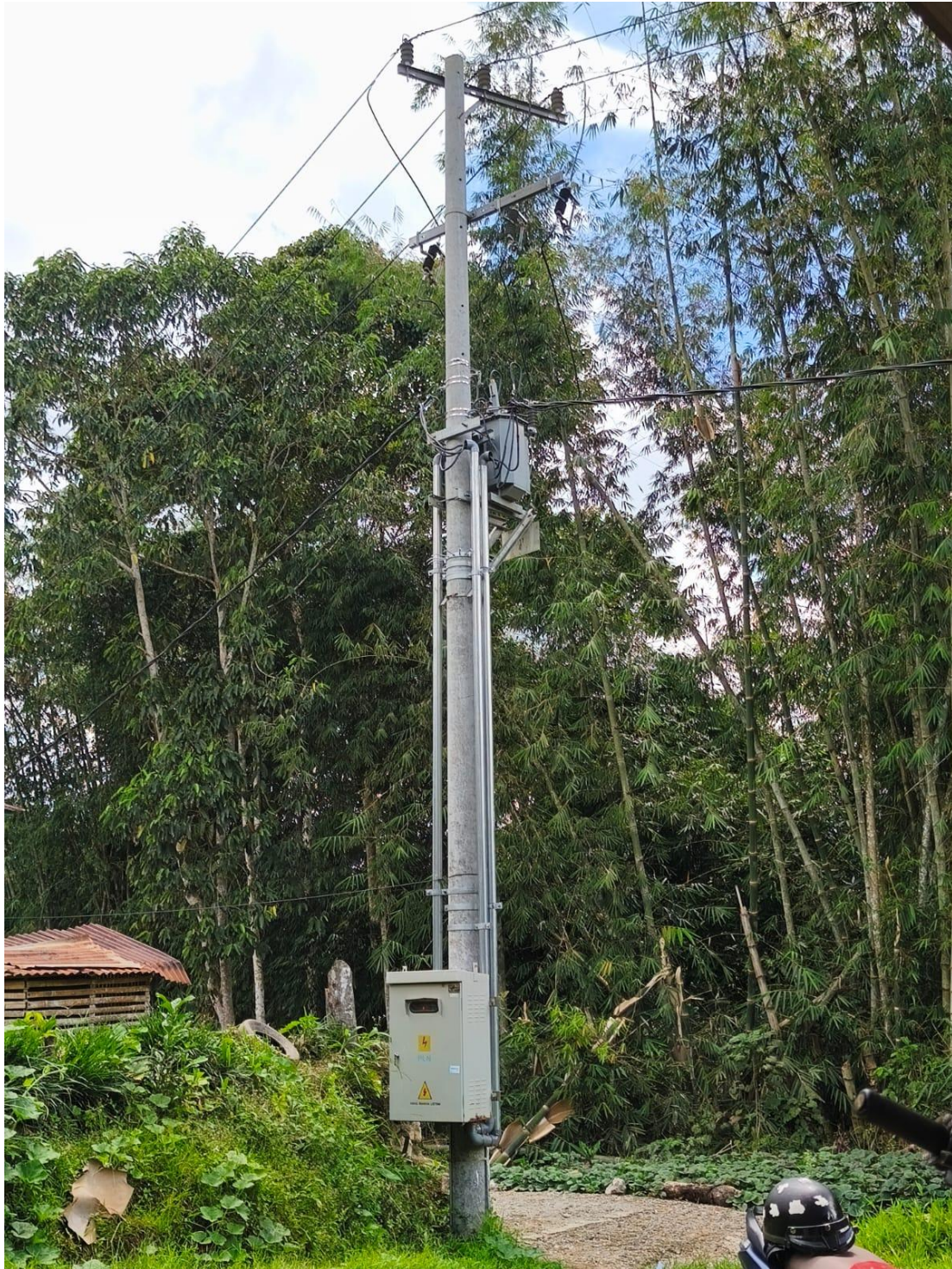
Gardu Trafo Tondon Siba'ta
