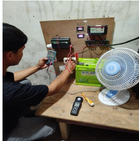
Gambar 1.5 Pengukuran pada Tegangan keluaran dari inverter
