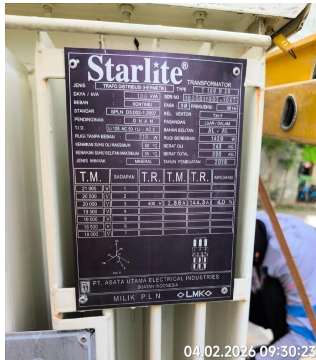
Gambar. Plat Nama (Nameplate) Transformator Distribusi 3 Fase
