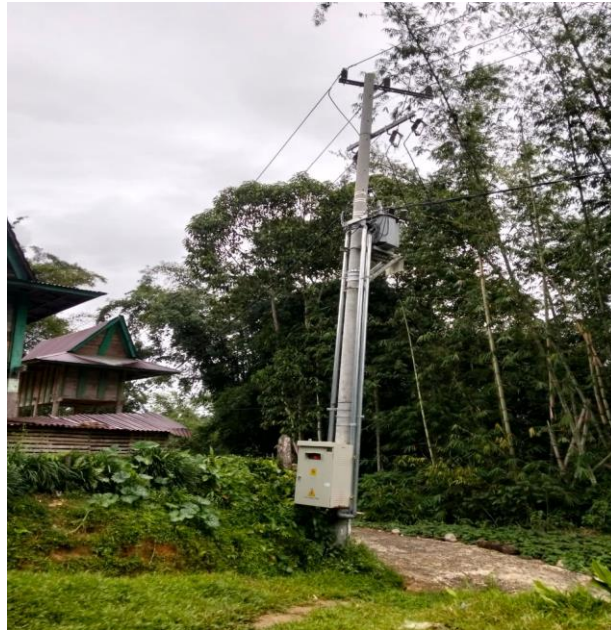
Gambar Gardu GD 680 AA Sesudah Perluasan Jaringan Tegangan Rendah (JTR)
