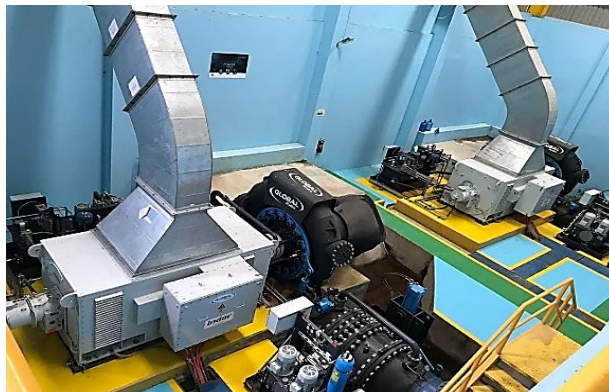
Gambar 2. 1 Pembangkit Listrik Tenaga Minihidro Sumber: (Dokumentasi Pribadi, 2024)
